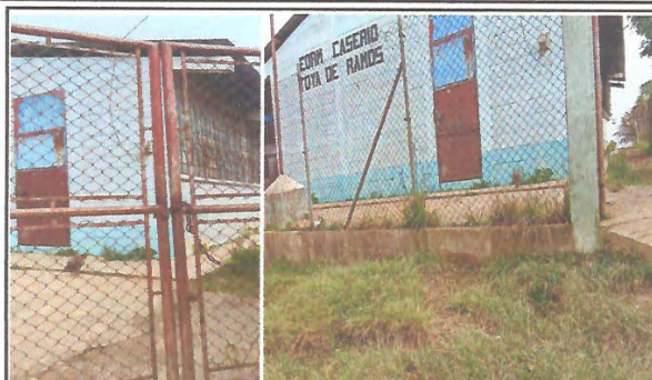
Foto 2: El ingreso al Centro Educativo necesita ser mejorado, particularmente el portón de ingreso.
