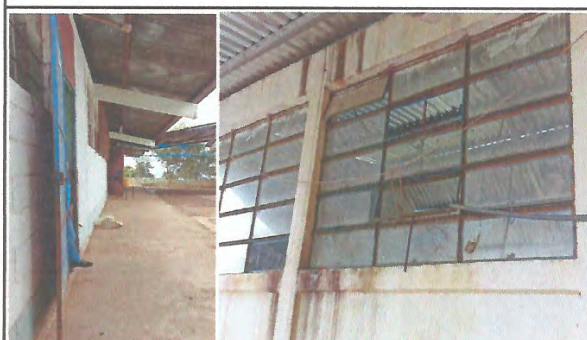
Foto 4: Necesidad de pintura general y mejoramiento de paredes en todo el centro educativo.
