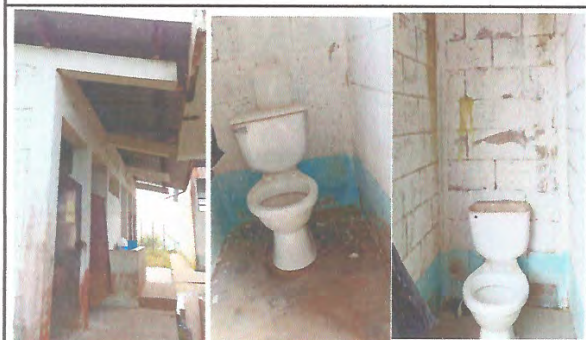
Foto 3: Se demanda remozamiento en los Servicios Sanitarios con azulejo, sustitución y mejoramiento de inodoros, puertas etc.
