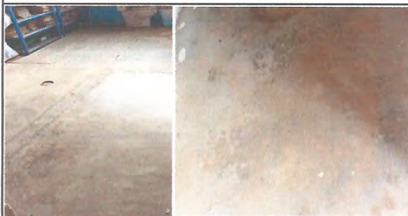
Foto 6: La comunidad educativa manifiesta daños en piso, por lo que existe oportunidad de instalar tipo cerámico o granito.
