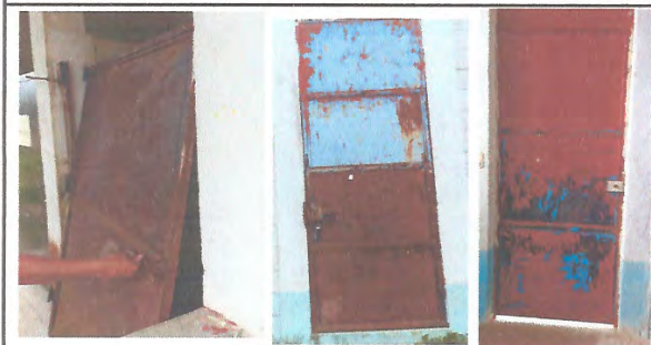
Foto 5: La Comunidad Educativa demanda el remozamiento de puertas metálicas.
